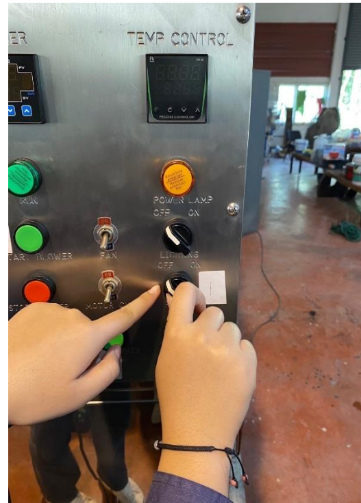
ทดสอบปุ่มปิดไฟภายในเครื่องอบแห้ง
